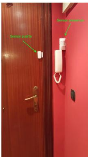
Figura 5.1 Configuración de sensores en la entrada de la vivienda
